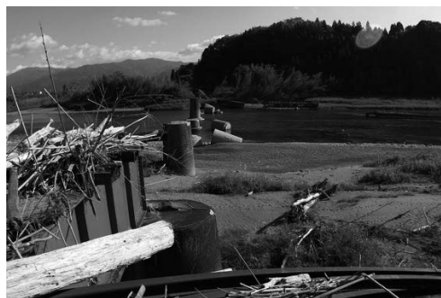
(被災した球磨川第4橋梁)
